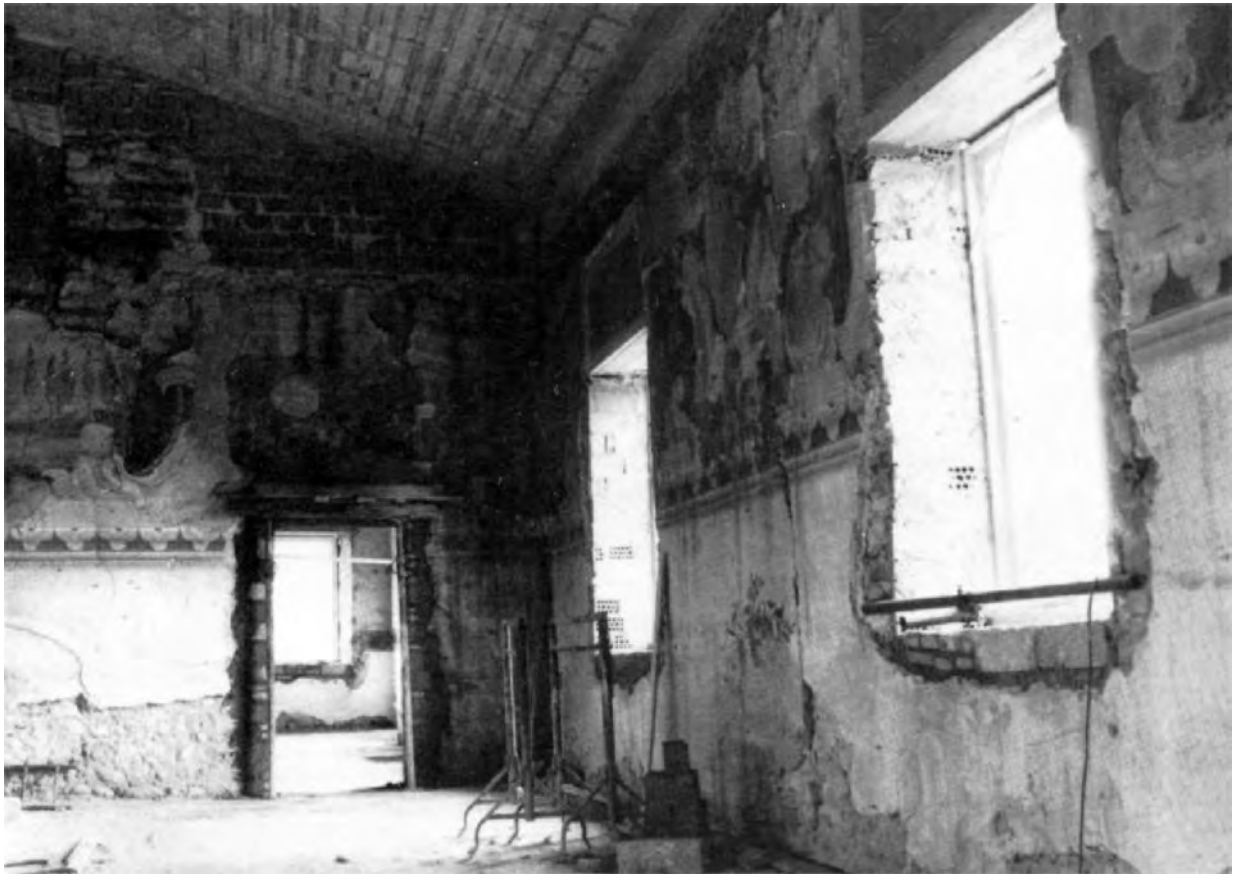
Due immagini dei danni provocati dall'incendio dell'oratorio.
